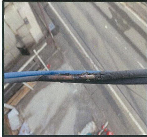
被覆が損傷した配線
