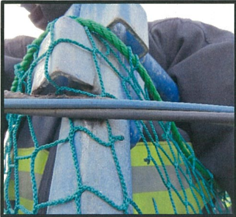
足場と接触した配線
